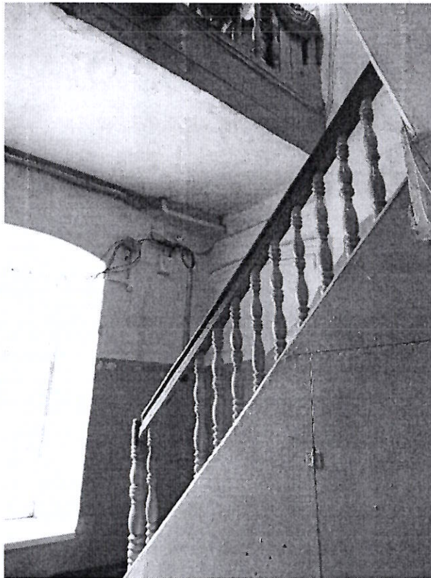
Фото 53. Утрата отдельного элемента ограждения лестницы в западном крыле здания
