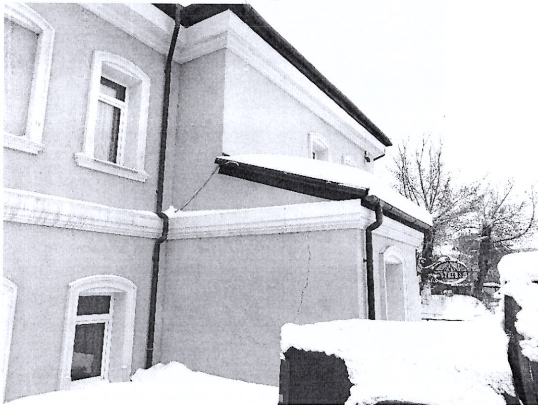
Фото 25. Фрагмент южного фасада южного крыла (трещина в стене пристроя)
