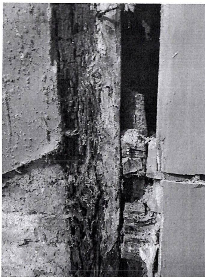
Фото 48. Биологическое повреждение древесины конструкций стены в западном крыле здания
