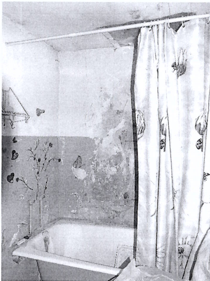
Фото 57. Разрушение отделочного слоя
