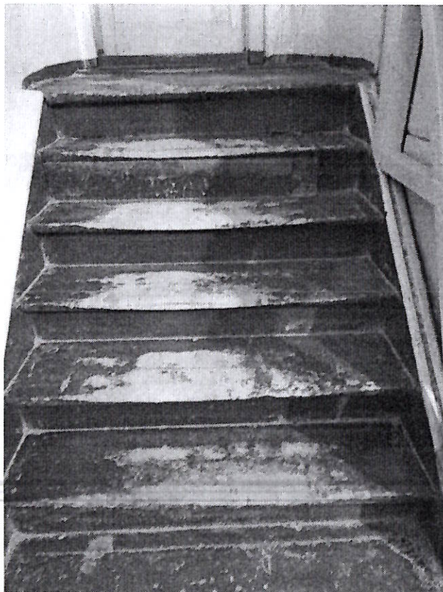
Фото 39. Лестница западного крыла (шелушение окрасочного слоя ступеней; деформации и сколы материала ступеней)
