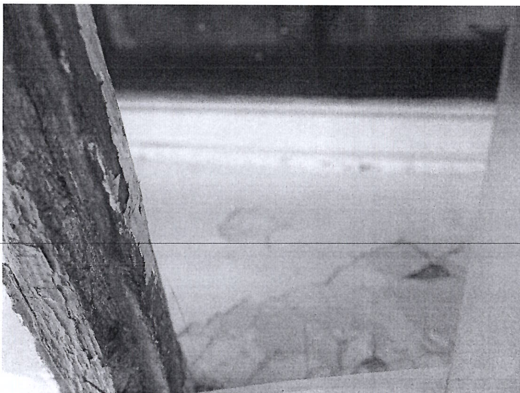
Фото 58. Окно западной части северного крыла (шелушение и отставание окрасочного слоя)
