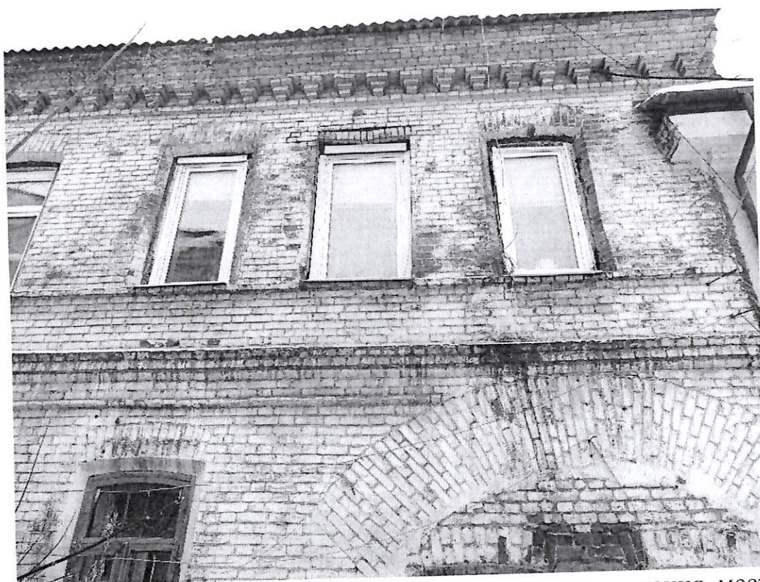
Фото 32. Фрагмент западного фасада западного крыла здания, место сопряжения с южным крылом (следы замачивания)
