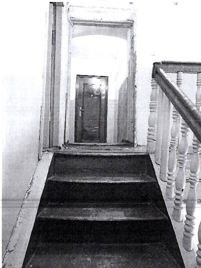
Фото 55. лестница в западном крыле, щель между конструкцией лестницы и стеной
