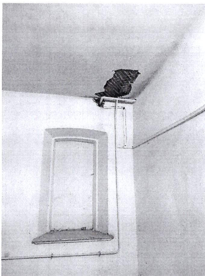
Фото 52. Деструкция штукатурного слоя до дрени; разрушение досок наката перекрытия
