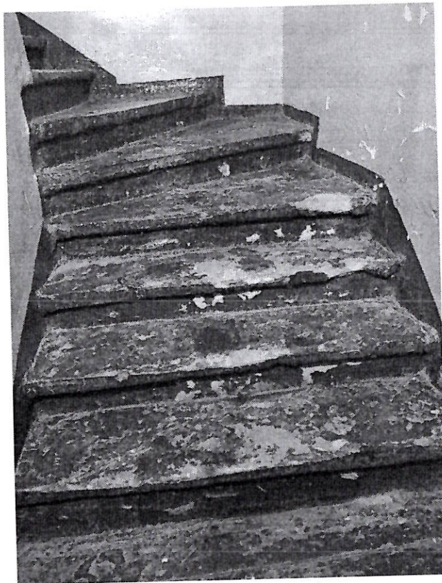
Фото 36. Лестница в западном крыле здания (шелушение окрасочного слоя ступеней; деформации и сколы материала ступеней)
