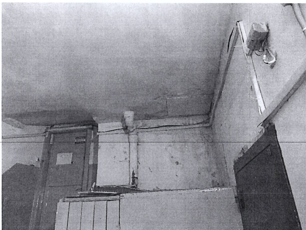
Фото 38. Помещение западного крыла здания (шелушение окрасочного слоя; следы замачивания)
