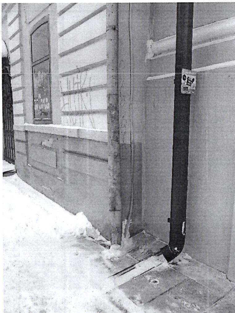
Фото 4. Фрагмент северного фасада северного крыла здания (вандажные надписи; деформация элемента водосточной трубы)
