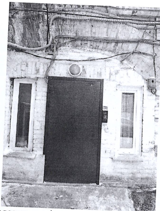
Фото 13. Фрагмент восточного фасада западного крыла здания, вход в жилую часть (разрушение отделочного слоя стен; разрушение бетона крыльца; следы замачивания)
