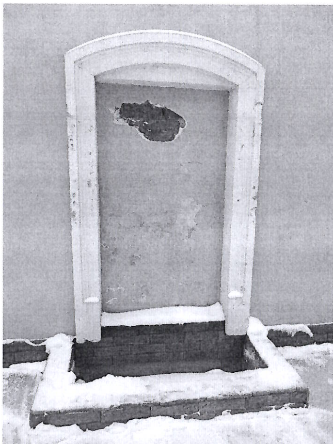
Фото 22. Фрагмент восточного фасада южного крыла здания (шелушение отделочного слоя стены)
