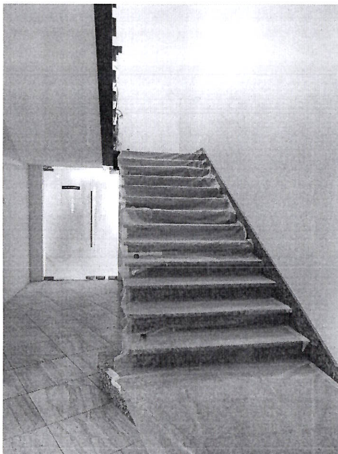
Фото 60. лестница северного крыла (отсутствует ограждение)
