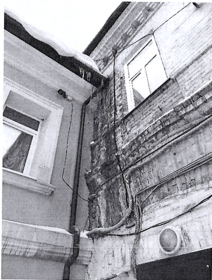
Фото 17. Угол сопряжения западного крыла с южным крылом (следы замачивания)
