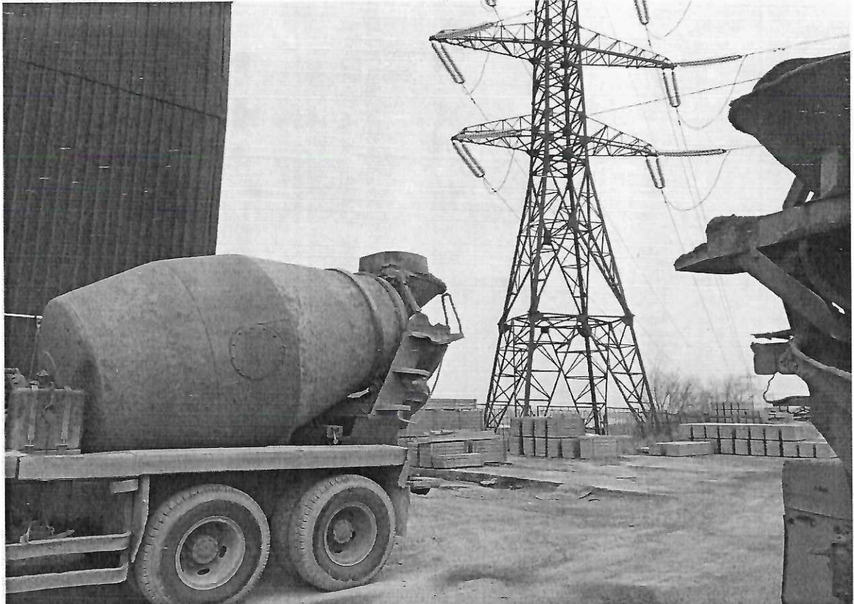
часть нежилого здания расположена в охранной зоне воздушной ЛЭП высокого напряжения Д-5/Д-6 "Левобережная - ЦРП-220".
