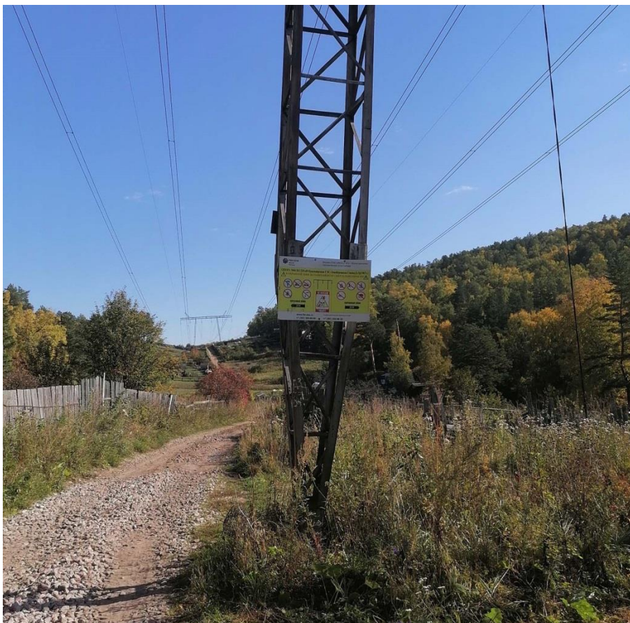
Рис. 4.39 ВЛ 220 кВ КГЭС - ПС "Левобережная", проходящая по СНТ "Родничок-2". Фото Антонов О.М.
