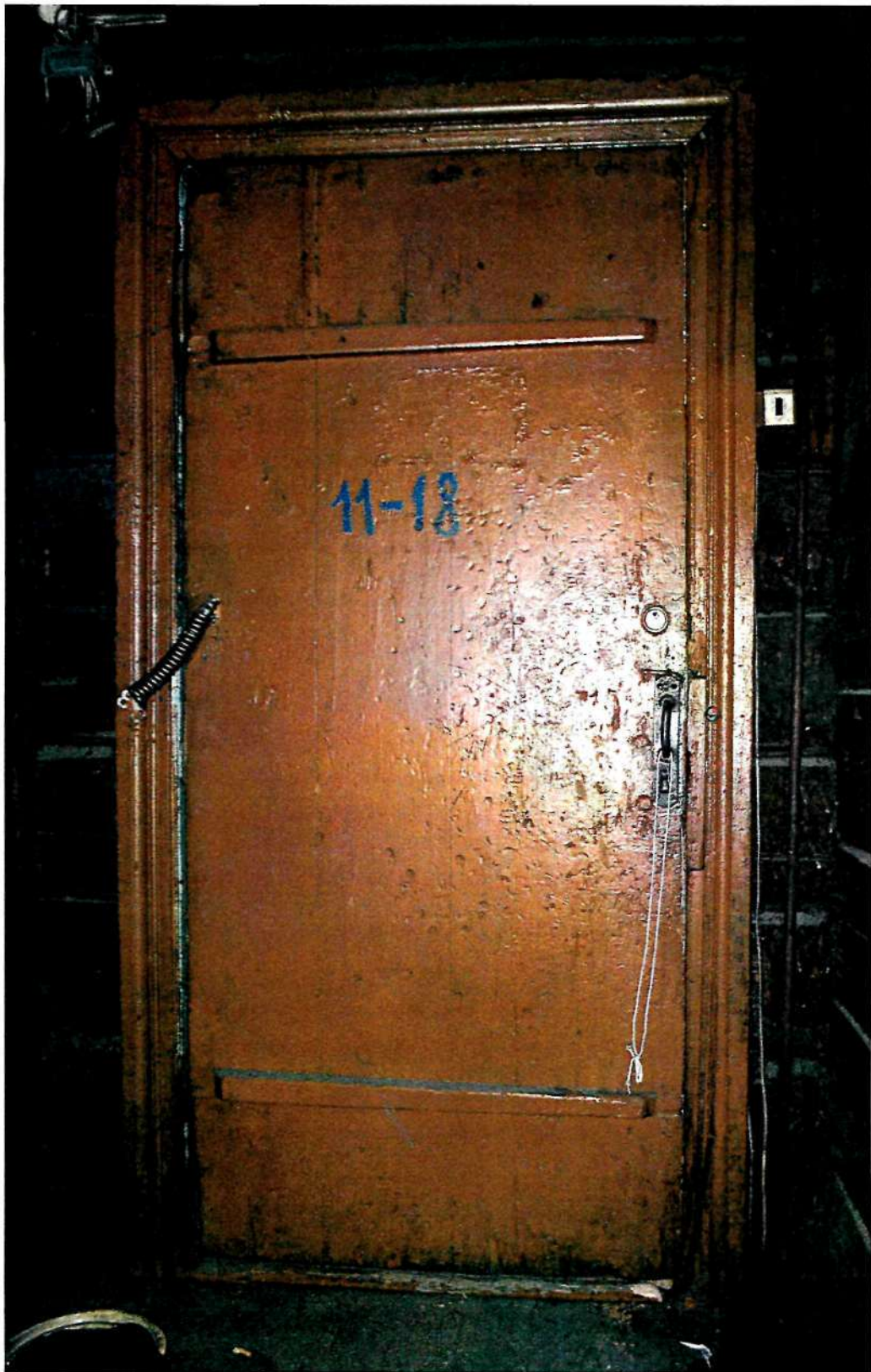
Фото 11. Дверь (тип 3) внутренняя однопольная щитовая (наборная из досок); всего в объекте сохранилось две двери такого типа, расположенные в проемах между коридорами первого и второго этажей и западной лестничной клеткой
